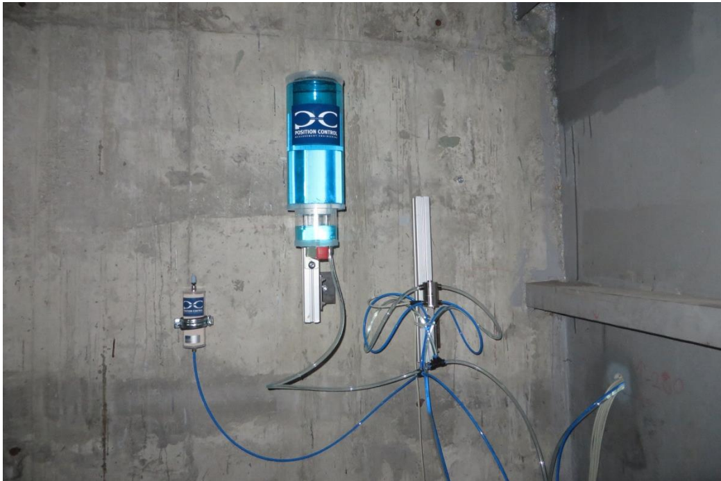
Abbildung 4: Schlauchwaagensystem Referenzsensor und Flüssigkeitsbehälter am Widerlager Arnoldstein, RFB Wien
