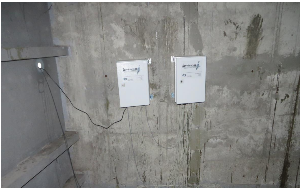
Abbildung 3: Schaltschränke am Widerlager Arnoldstein, RFB Wien
