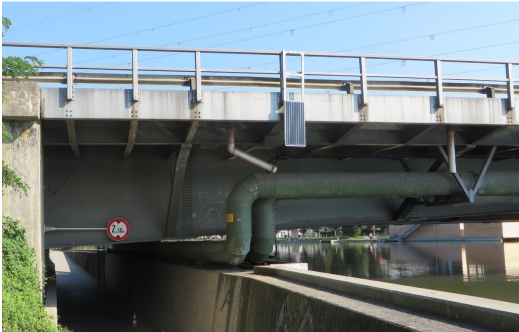
Abbildung 2: Solarpanel zur Stromversorgung am Widerlager Arnoldstein
