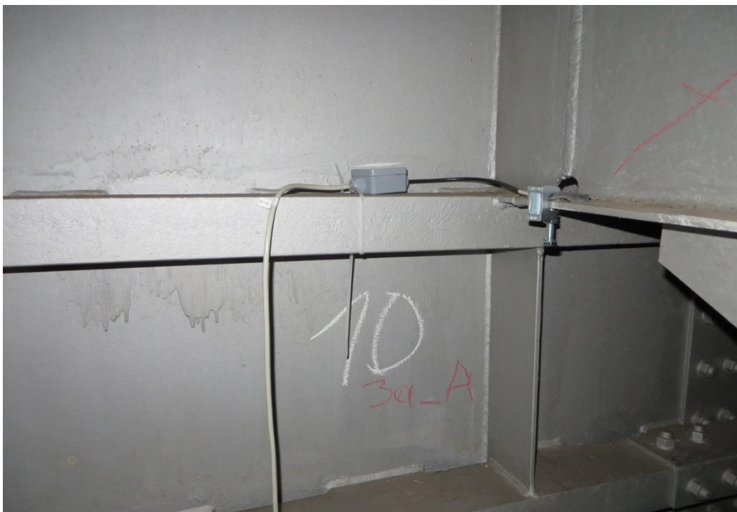
Abbildung 5: Bauwerkstemperatursensor am Messpunkt ST_RFB_AS_3a_A
