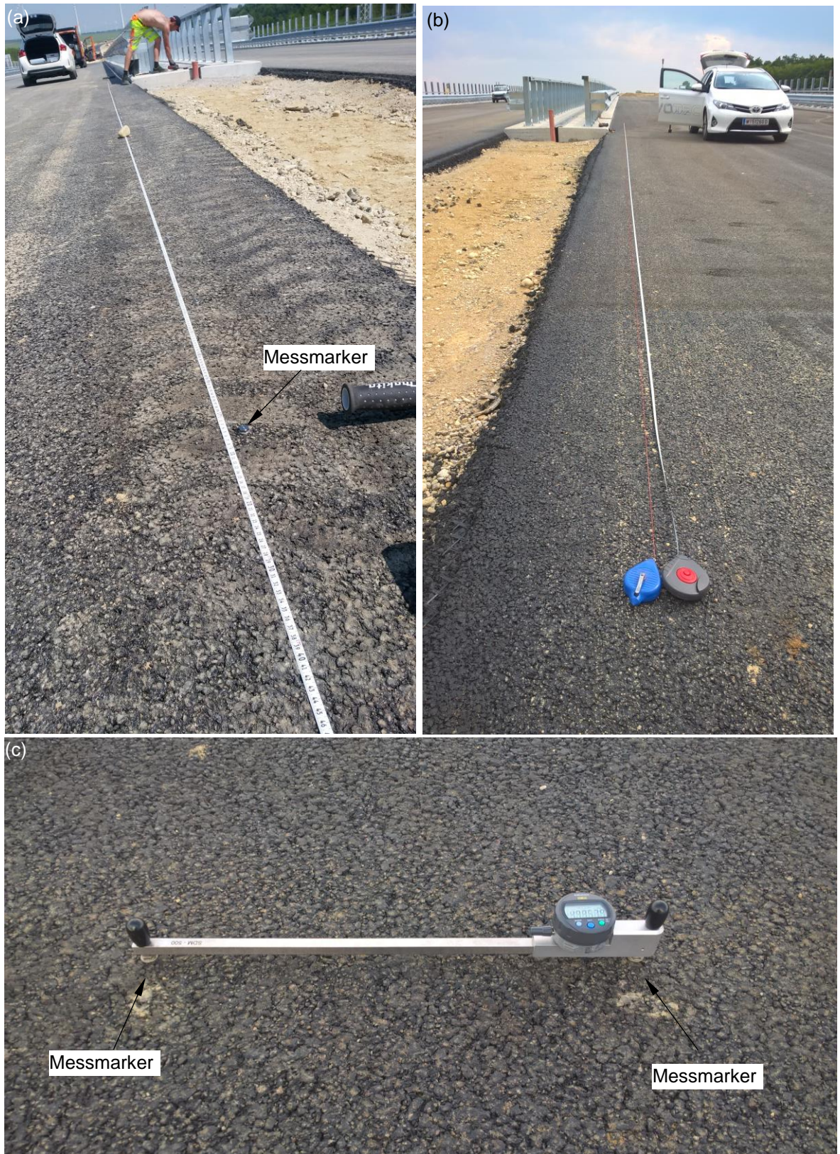
Abbildung 25:41 Messmarken ALT 0,40m vom Fahrbahnrand , alle 0,50m über 20m Länge je RFB nahe Innenstreifen (a) RFB-Staatsgrenze, (b) RFB-Wien und (c) Nullmessung - Präzisionsmessung mit Setzdehnungsmessgerät am 30.05.2017.
