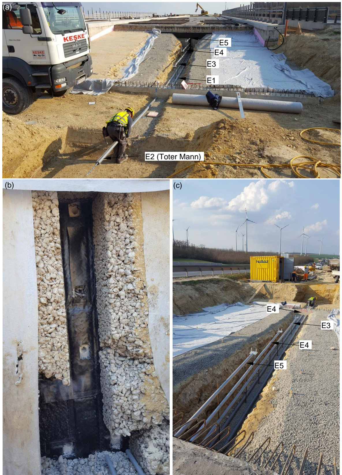
Abbildung 24: (a) Schleppplattenbereich Widerlagerwand bis Verankerung (b) Durchführungen durch die Widerlagerwand und (c) frei monierte Extensometerstangen im Hüllrohr vor der Fertigung der Schleppplatte.
