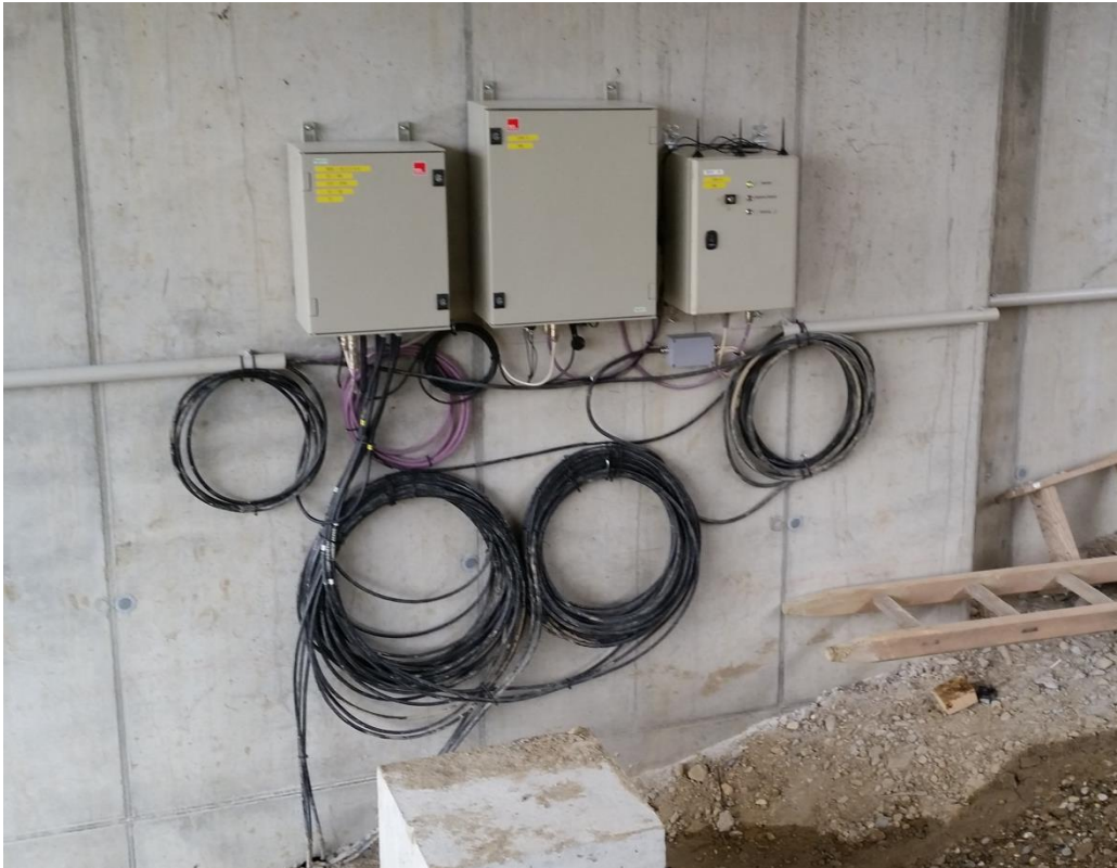
Abbildung 10: Messzentrale im Widerlager (Achse 6)
