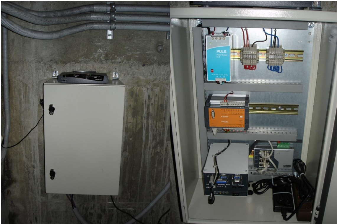
Abbildung 5: Messzentrale des Monitoringsystems am Objekt
